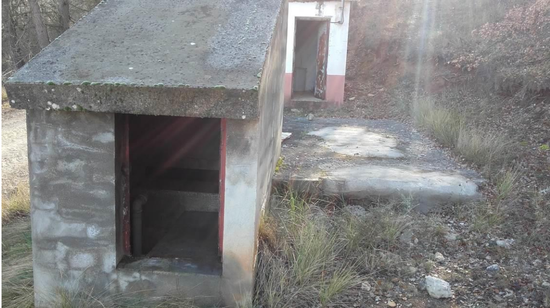
Manantial 1 "Masegal" y Depósito. Panorámica
